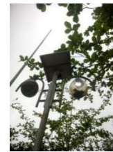
Gambar 1. Lampu Taman Rusak Ringan
