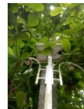
Gambar 2. Lampu Taman Rusak Sedang
